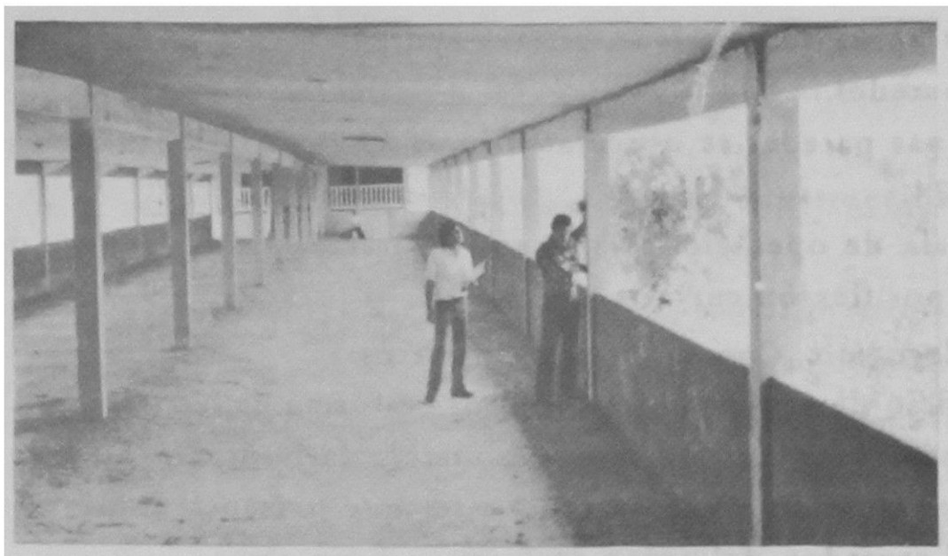
Fig. 7. Vista interior de edificio de pasillos del Instituto Pedagógico. Se pueden apreciar defectos señalados en el texto.
