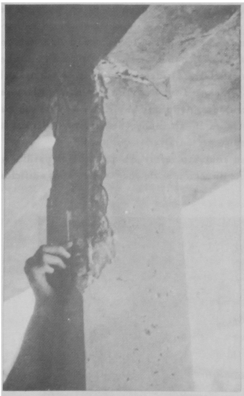
Fig. 8. Daños en una columna del edificio de Fig. 7. Nótese la falta de estribos.
