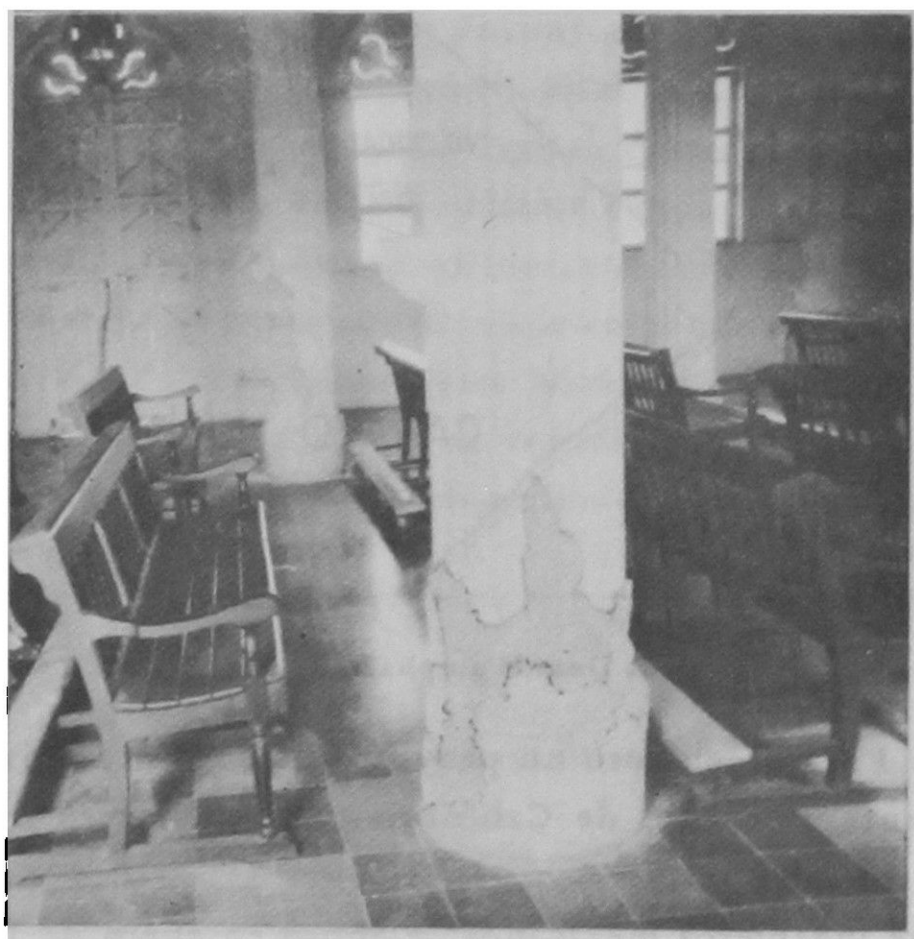
Fig. 3. Columna fallada en iglesia de San Antonio
